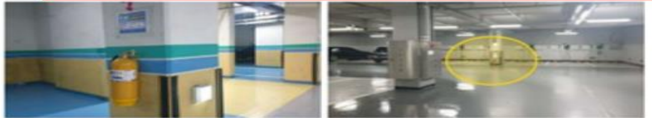
<그림 33> 전기차 충전구역에 설치된 D급 소화기(좌). 전기차 충전구역에 근접 배치된 소화기(우)
