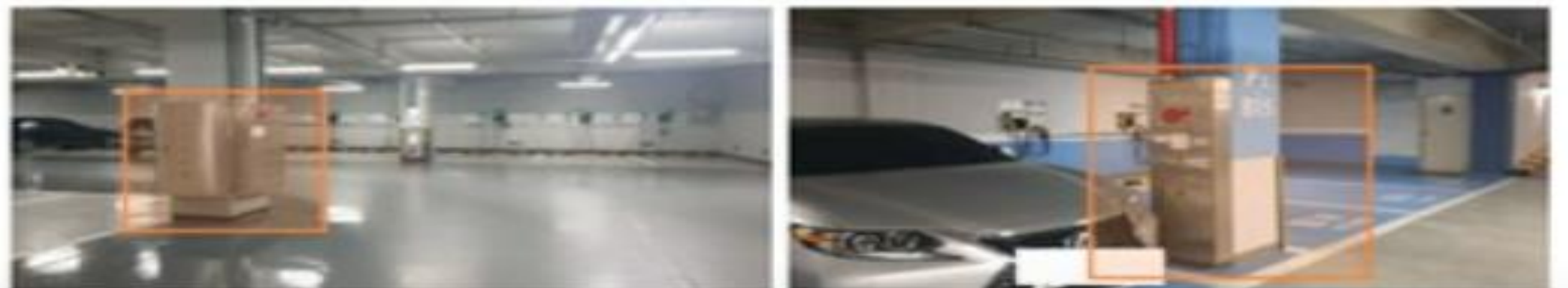
<그림 34> 전기차 충전구역과 이격된 옥내소화전(좌). 근접설치된 옥내소화전(우)
