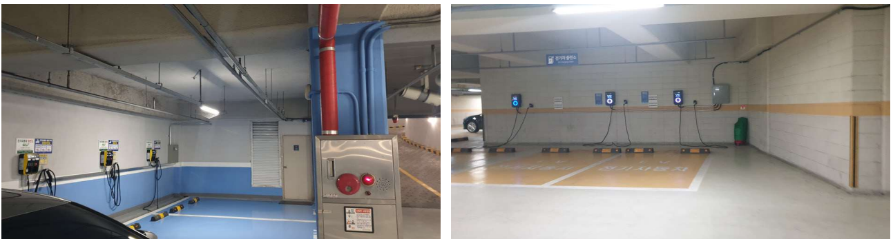
<그림 35> 화재감지기가 설치되지 않은 전기차 충전구역
